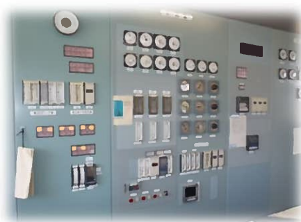
老朽化した中央監視室（高丘浄水場）
