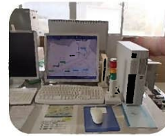
水質監視システム 市内の水質を浄水場で監視します。
