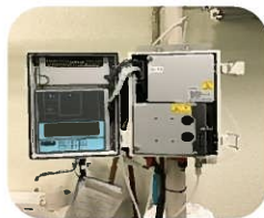
水道水自動測定装置 市内の水質（色、濁り、消毒効果）を常時測定します。
