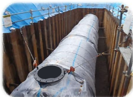
緊急貯水槽設置状況
